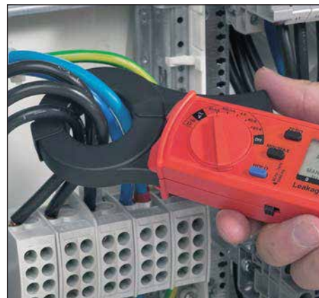
Differenzstrommessung mit Leckstromzange
